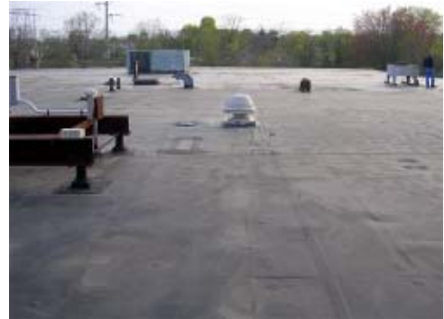
Roof 2 Exhaust Fan
